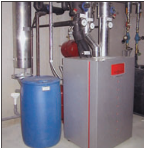
Bild 4d: Wärmepumpe (Quelle: PKi)
