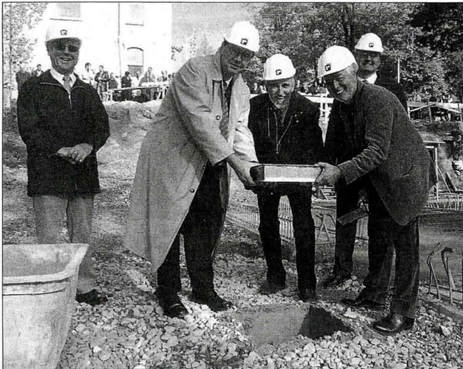
Jetzt kann es mit dem Bau beginnen (von links): Synodalpräsident Horst Neugart, Hans-Dieter Wille, Christian Rose, Hans Klumpp und Hans Schmid bei der Grundsteinlegung. Bild: Richard Zeller
